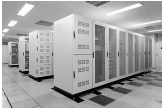
「iDC」内のサーバ
